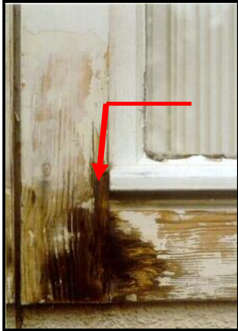
ENSAMBLES EXPUESTOS A LA HUMEDAD
